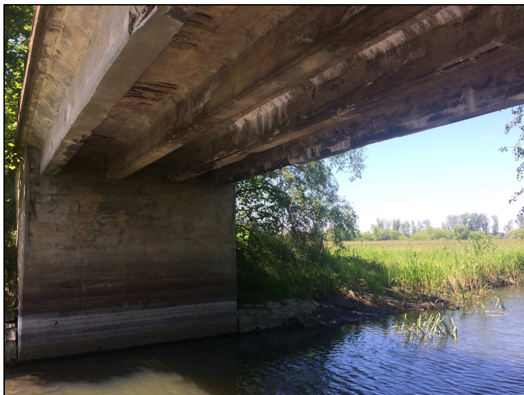
Abbildung 11: Ansicht des westlichen Widerlagers des geplanten Brückenabbruchs Gemarkung Rathenow Flur 9 Flst. 8, 9 u. 34 (Aufnahme 05/2017)
